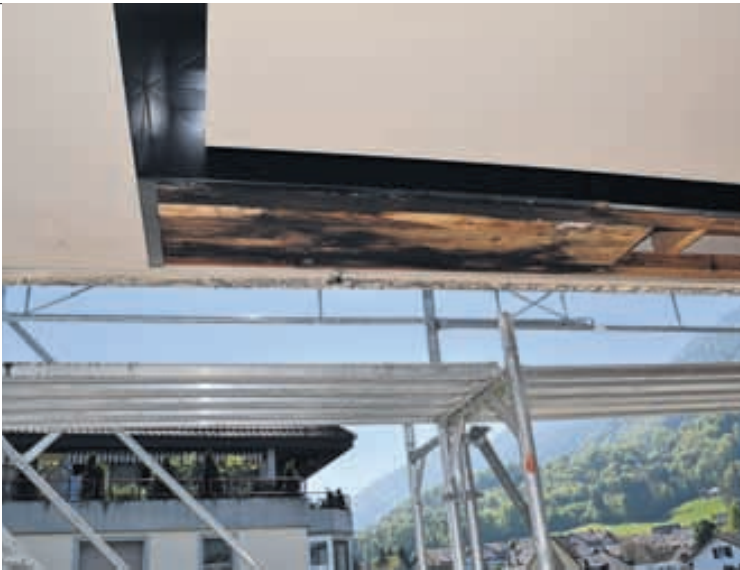
Unterhalb der Betonelemente kam angefaultes Holz zum Vorschein. Eine Expertise soll nun klären, wie Wasser und Feuchtigkeit in die Hohlräume gelangten.
